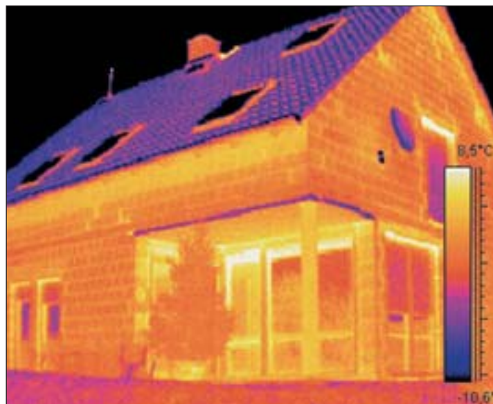
Die Thermoaufnahme zeigt es: Wo die Farben am hellsten sind geht am meisten Energie verloren.
