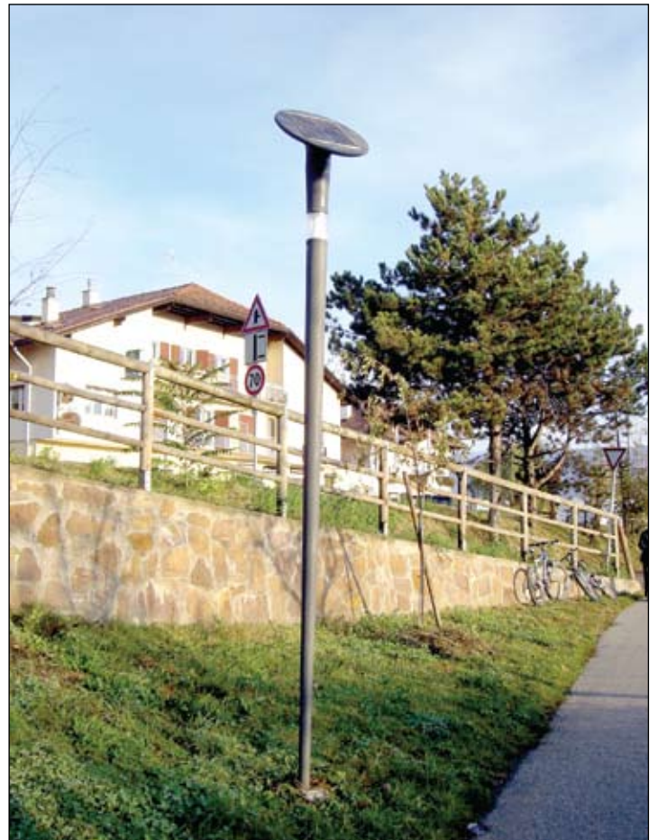
Die neue Solarbeleuchtung am Radweg
