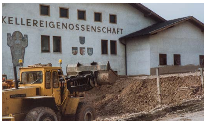
^ Nur mit schweren Maschinen konnten die gewaltigen Schlamm- und Geröllmassen vor der Kellereigenossenschaft Tramin weggeräumt werden.
