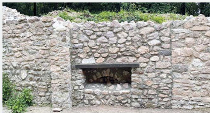
~ Eine Mauer diente als Schutz vor weiteren Vermurungen
