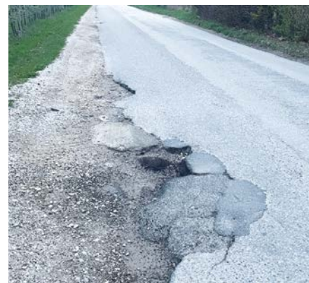
^ Asphaltflicken, Risse, Schlaglöcher und Schotterbankette zum Ausweichen am Bahnweg sind bald Geschichte
